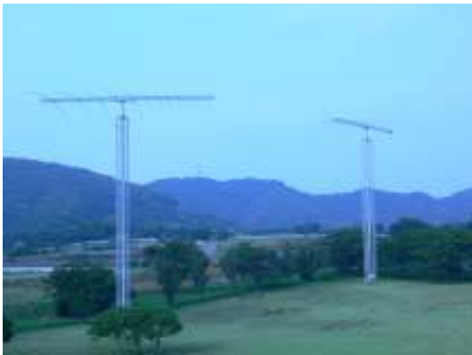
写真1 短波帯以下の電波を受信するための空中線施設群
